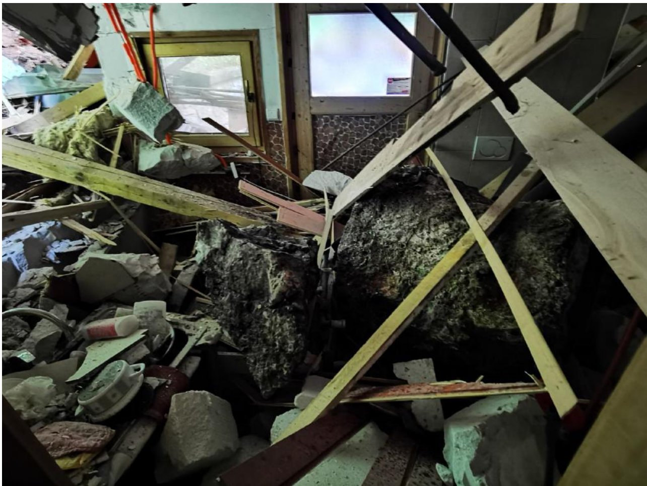
Slika 2. Skalni balvan velikosti okoli 1,8m 3 , ki je padel na objekt Zagorica 15.
