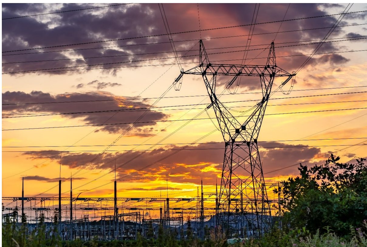
Na območju občine je locirano eno od ključnih vozlišč elektroenergetskega omrežja v državi. / Avtor: I. Marjanović, 2026
